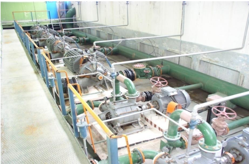
Приміщення насосної станції 9 - Р8
