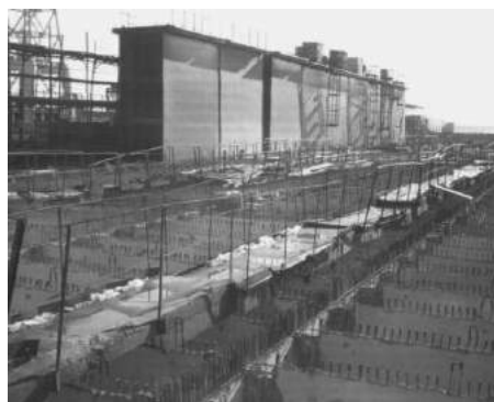
Рисунок 9 - Установка в большой док-камере блоков башни на железобетонный понтон композитного дока подъемной силой 8500 т
