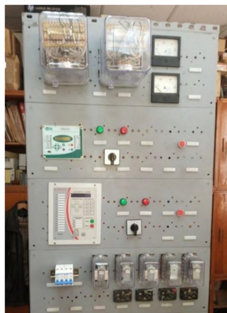
б – нова панель захисту силового трансформатора на основі мікропроцесорних пристроїв
