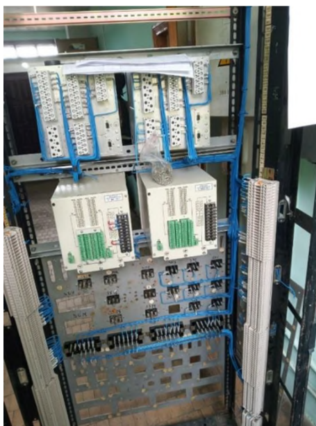
Рис. 4. Панель захисту силового трансформатора для підстанції 110/35/10 на основі SIEMENS SIPROTEC та РЕЛСІС
