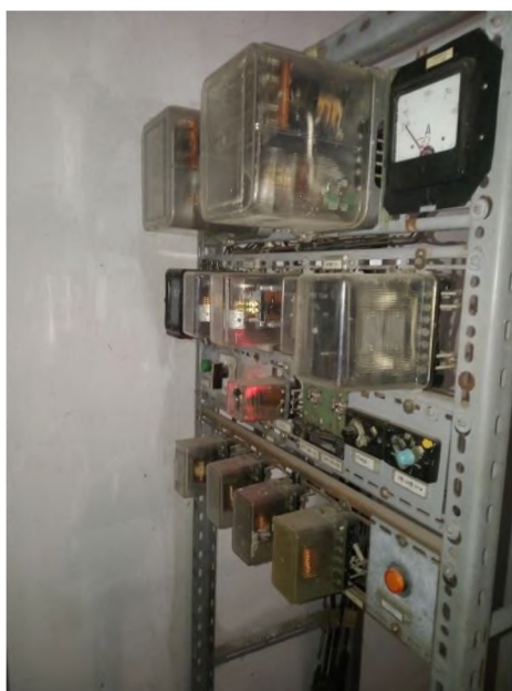
а – стара панель захисту силового трансформатора на базі електромеханічних реле
