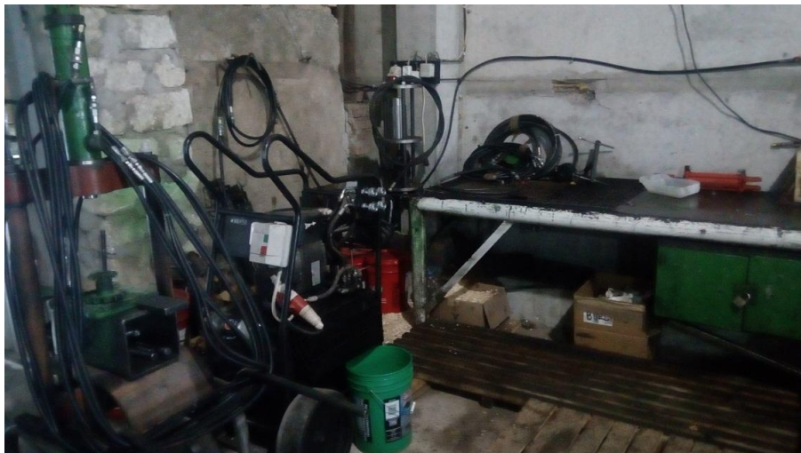
Рис. 4. Дільниця з ремонту та діагностики гідравлічного обладнання
